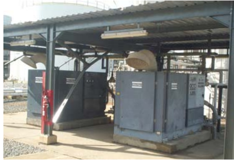
Figura 4.5: Compresores de Aire K-5401 A/B. Fuente: Propia.
