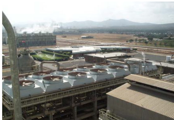
Figura 4.2: Enfriador de Gas Reformado. EA-4101. Fuente: Propia.
