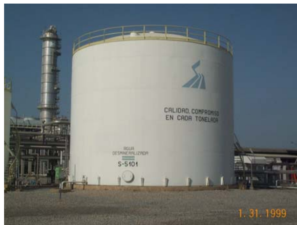
Figura 4.4: Tanque de Agua Desmineralizada S-5101. Fuente: Propia.
