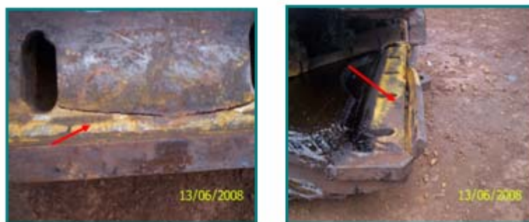
Figura 4.26. Fractura por fatiga de las pestañas de los bloques de soporte de los brazos del balde.
