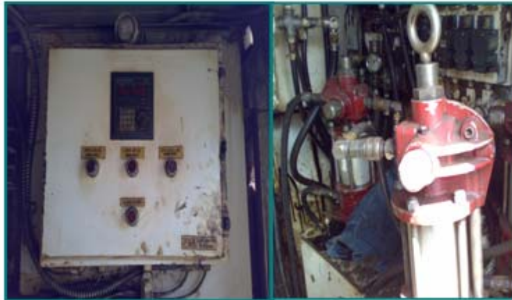
Figura 4.16. Vista del controlador lógico programable (PLC) y bombas de grasa para engranajes abiertos.
