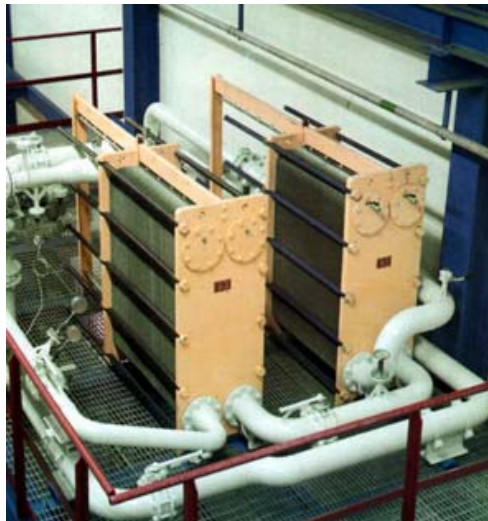
Intercambiador de calor de placas
