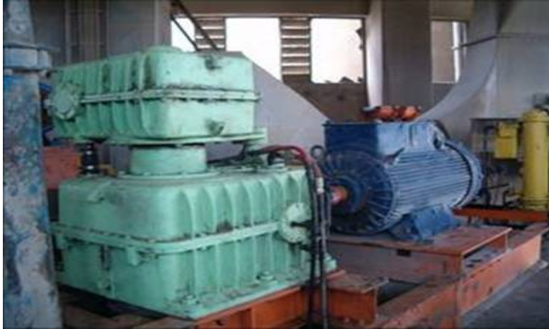
Fig. 3.7 – Motores y reductores principal y secundario del Separador. Electrofiltro o Precipitador electrostático (despolvamiento del Molino).
