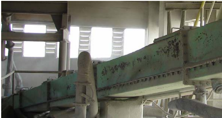
Fig. 3.10 – Aerodeslizadores (sistema transporte neumático).
