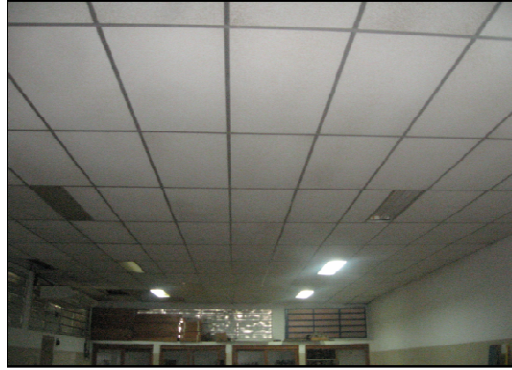
Figura 5.5 Condición de iluminarias.
