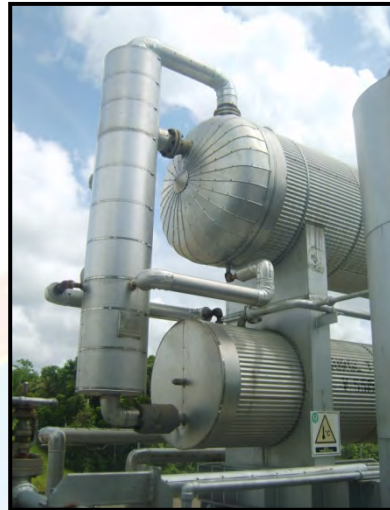
Figura 2.7 Columna de Despojamiento Fuente: PDVSA 2006
