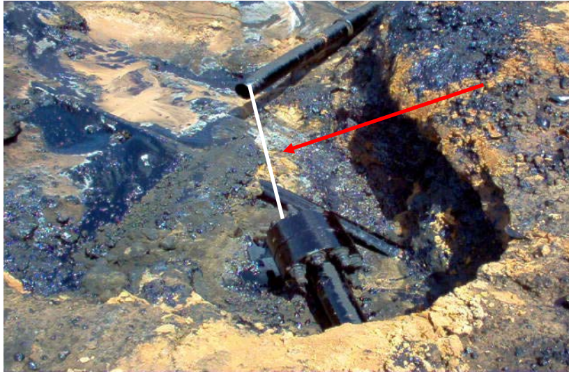
Figura 4.9 Tramo de Tubería rota del Pozo Inyector ORI-172
