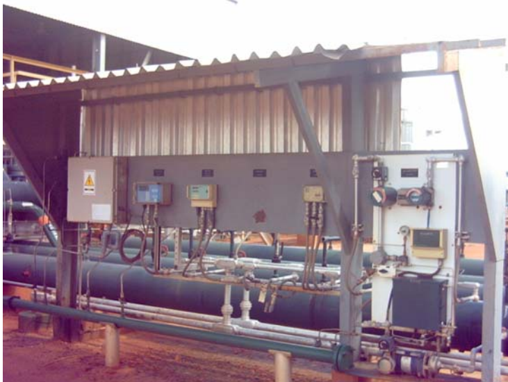
Figura C-16 Equipos medidores en lín
