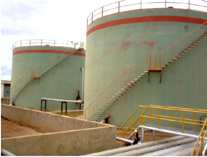
Figura C-13 Tanques Almacén PITASO
