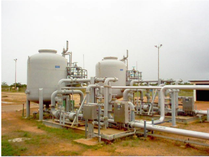
Figura C-15 Unicel fuera de servicio PITASO
