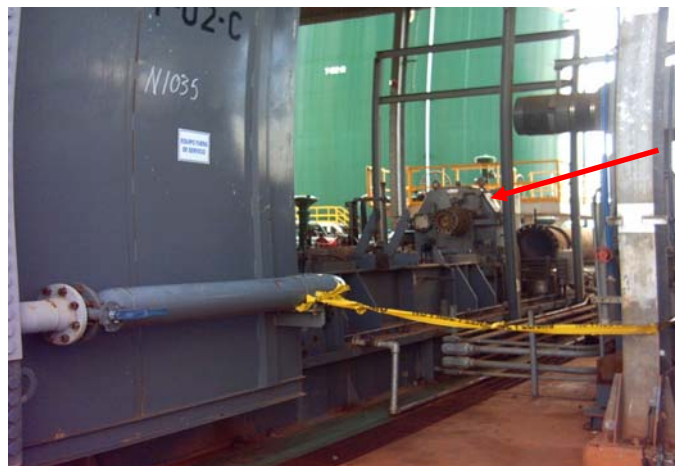
Figura 4.7 Falta de equipo de Inyección (Reparación mayor)
