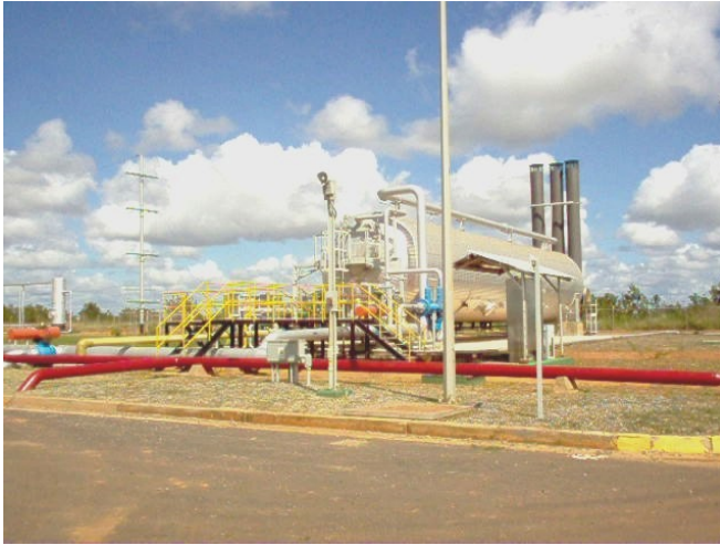
Figura C-7 Despojador de agua libre (FWKO) PTCO
