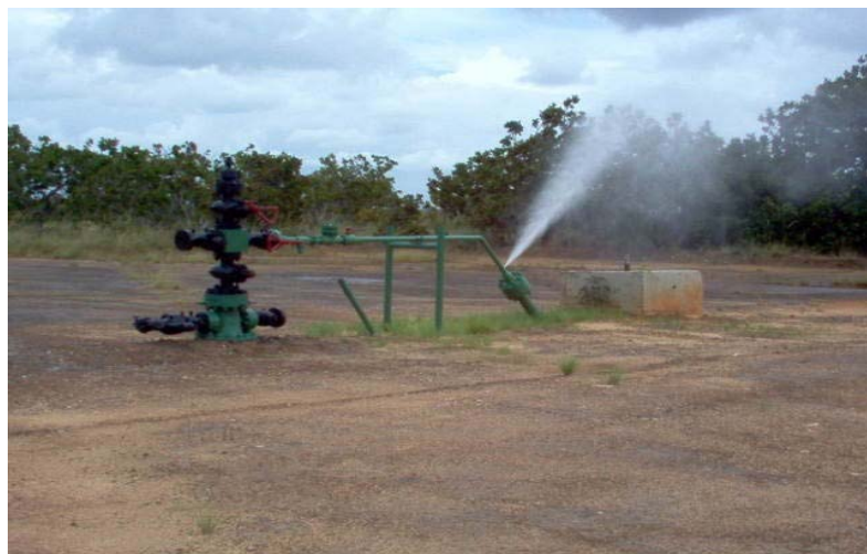
Figura 4.8 Filtración en tubería del pozo inyector ORM- 7
