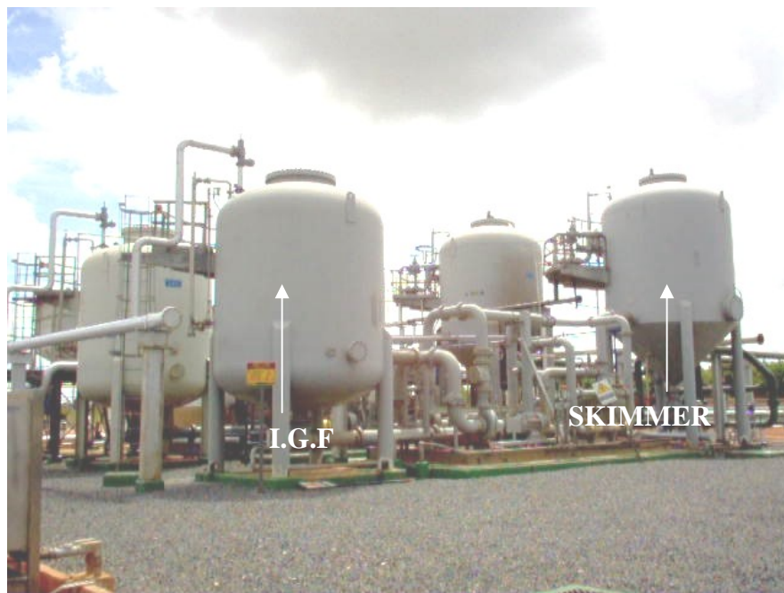
Figura 2.1 Equipo de Tratamiento de Agua (UNICEL), Ubicado en las PIAS
