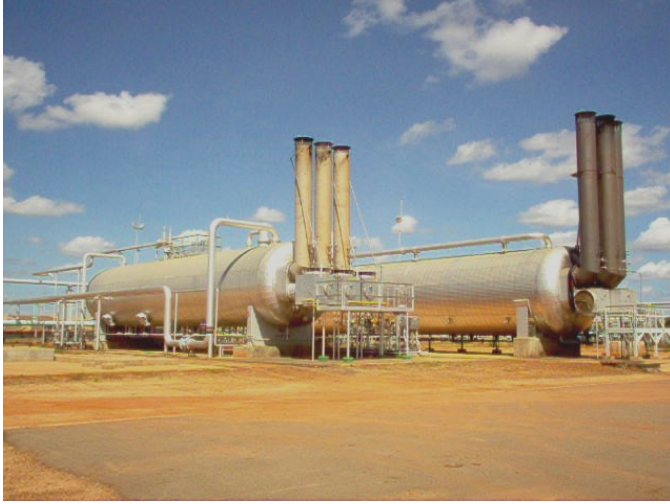
Figura C-11 Separadores trifásicos C y D ORED-7
