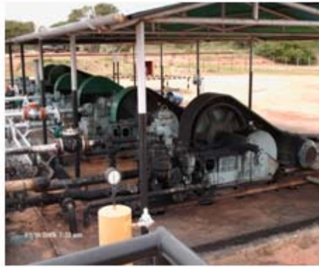
Figura 4.6: Bombas de inyección de agua.
