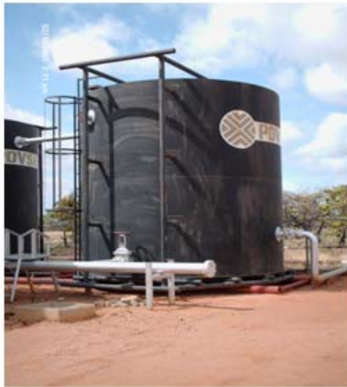
Figura 4.4: Tanque de inyección de agua.
