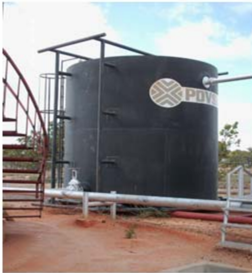
Figura 4.3: Tanque principal de agua.
