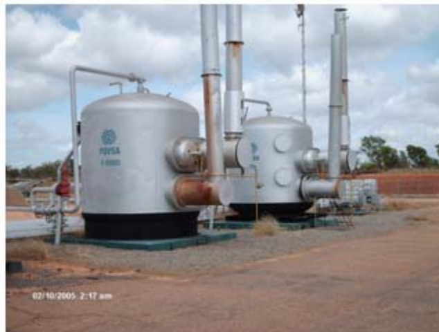
Figura 3.2: Tanques calentadores de crudo BARED-8.
