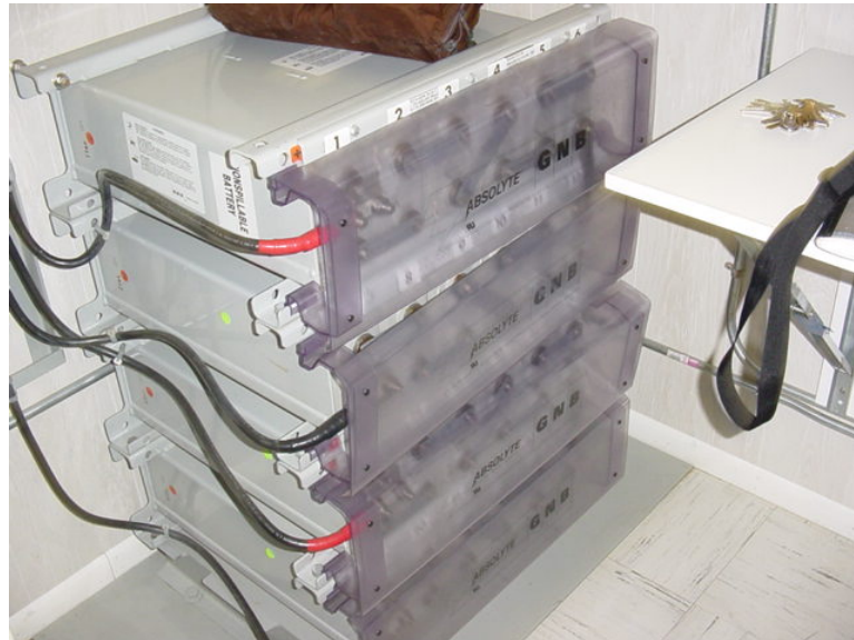
Figura 3.3. Baterías de una Estación Radio Base
