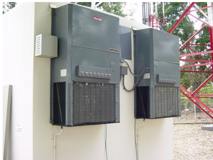
Figura 3.5. Aires Acondicionados de una Estación Radio Base
