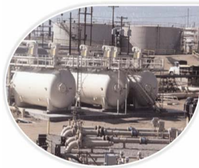
Figura 2.12 Vista externa de filtros cáscara de nuez (Petreco, 2003).
