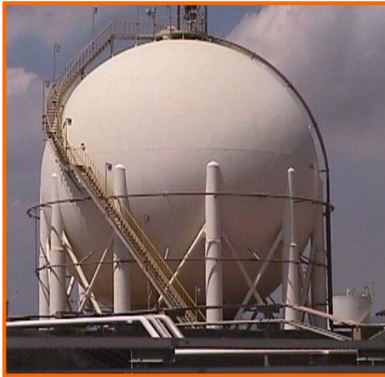
Figura 2.13 Tanque esférico presurizado
