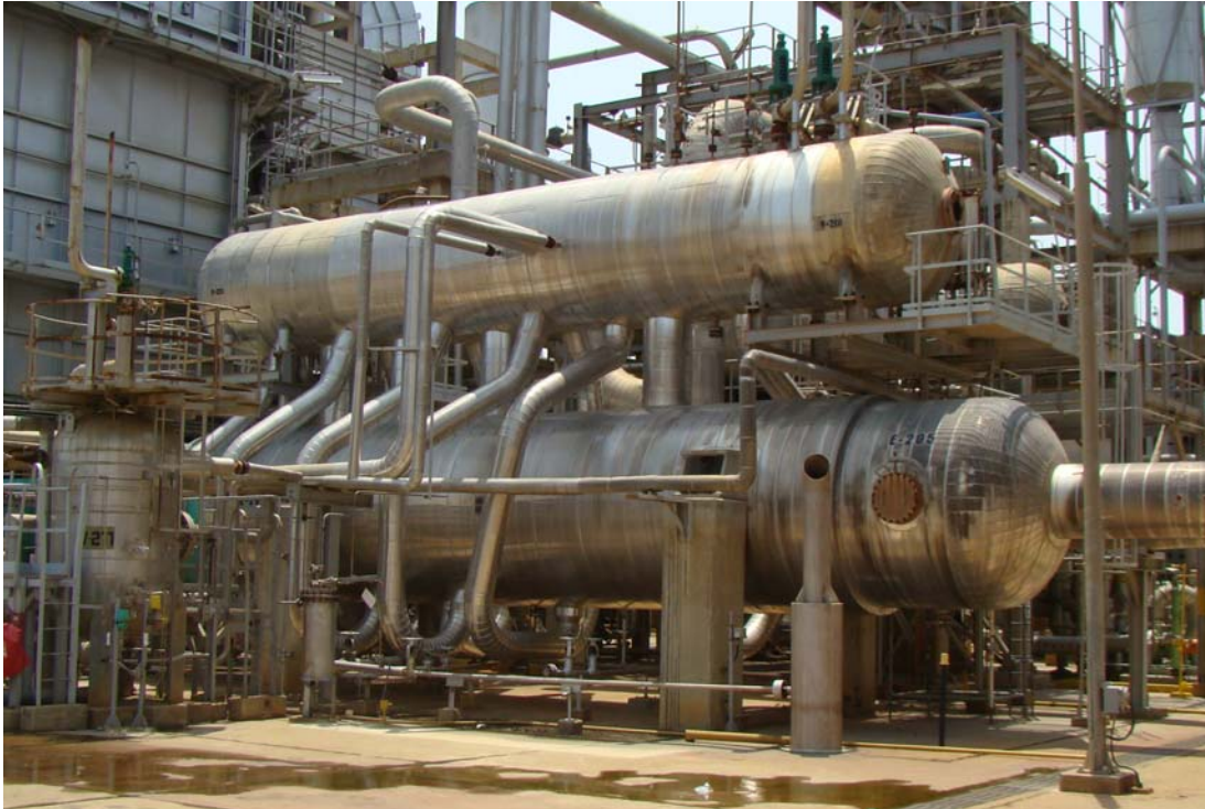
Figura 2.20. Caldera de vapor de alta presión E-205 y V-201 (domo superior).
