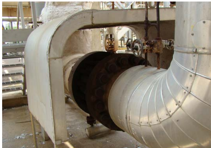
Figura 4.11. Válvula check del cabezal de vapor de alta presión luego de la parada de planta de 2006.
