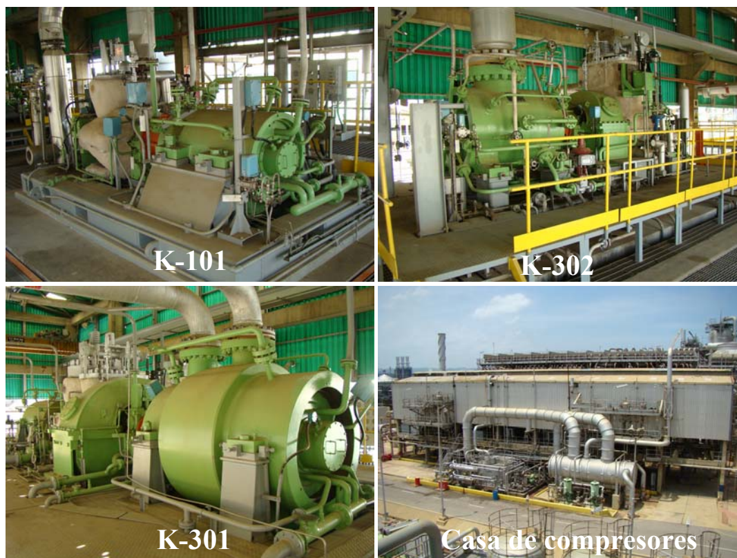
Figura 2.14. Compresores de proceso de la planta Metor.
