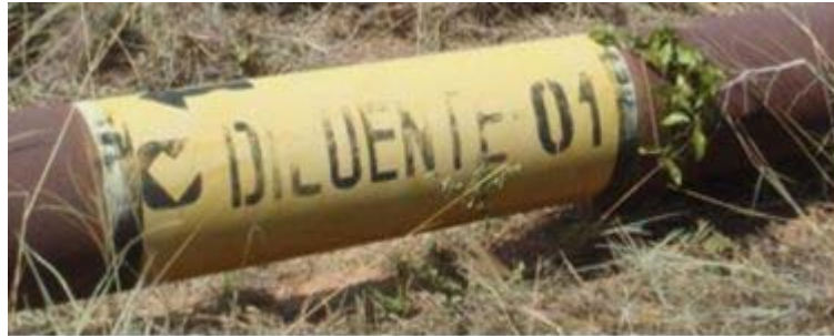
Figura 2. 2. Tubería de diluyente de COB a Arecuna
