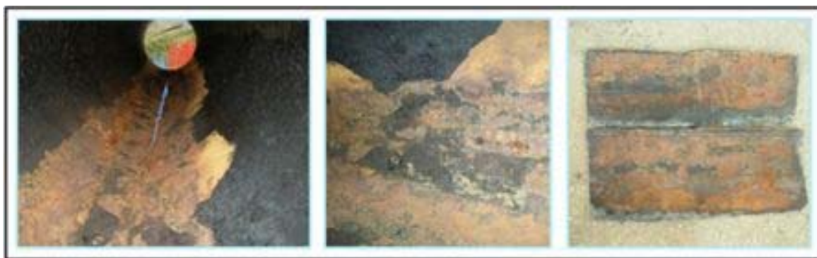
Figura 4.4. Vistas de la corrosión presente en la tubería de 12” con servicio de crudo diluyente COB- AREM2, localizada en la hora seis alrededor de la ZAT
