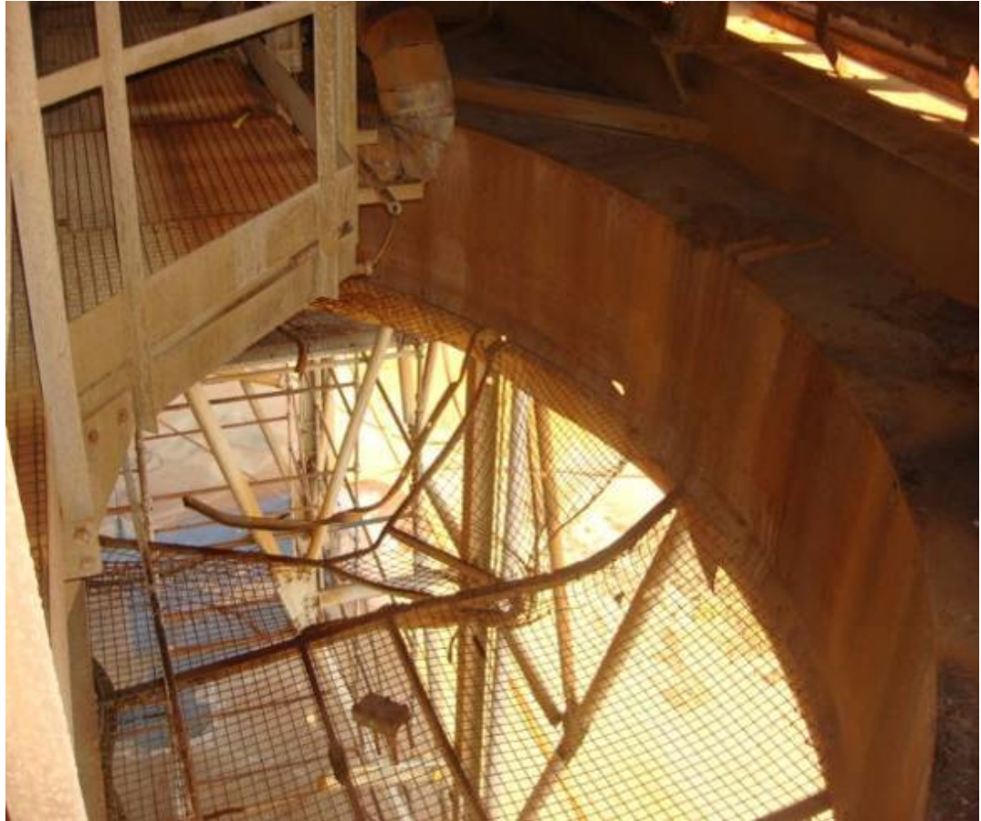
figura 0.5. Ruptura del protector del aspa del ventilador
