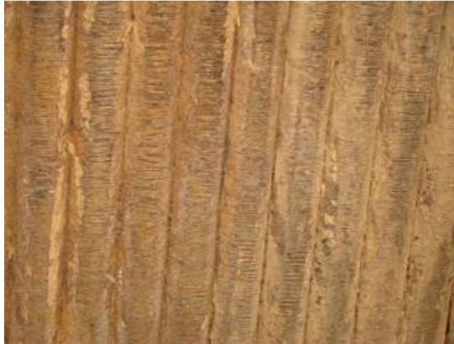
figura 0.4. Formación de incrustaciones de oxido sobre las aletas de los haces de tubos
