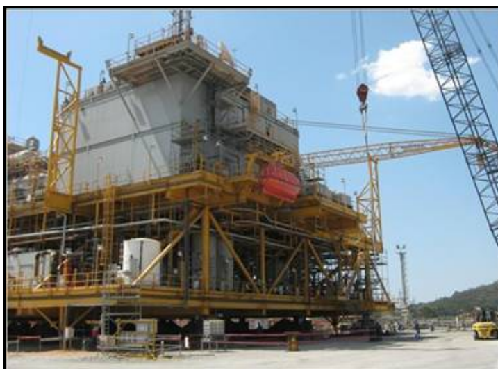
Figura 1.3 Vista lateral derecha de la facilidad central de producción (PDVSA Petrosucre, 2008).
