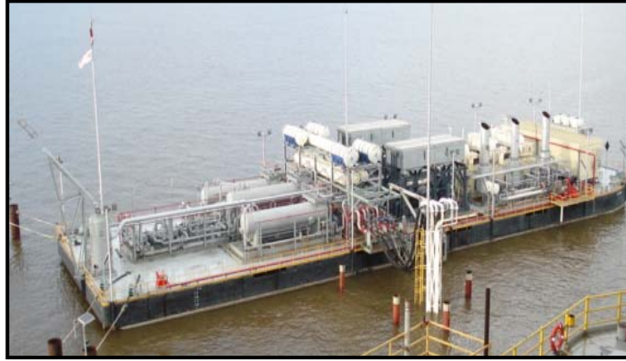
Figura 1.6 Vista general de la plataforma de procesamiento temporal (PDVSA Petrosucre, 2008)
