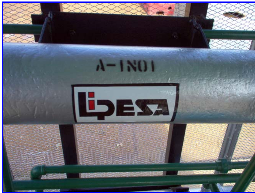
Figura 3.6. Intercambiador A-IN01 del sistema de enfriamiento piloto.
