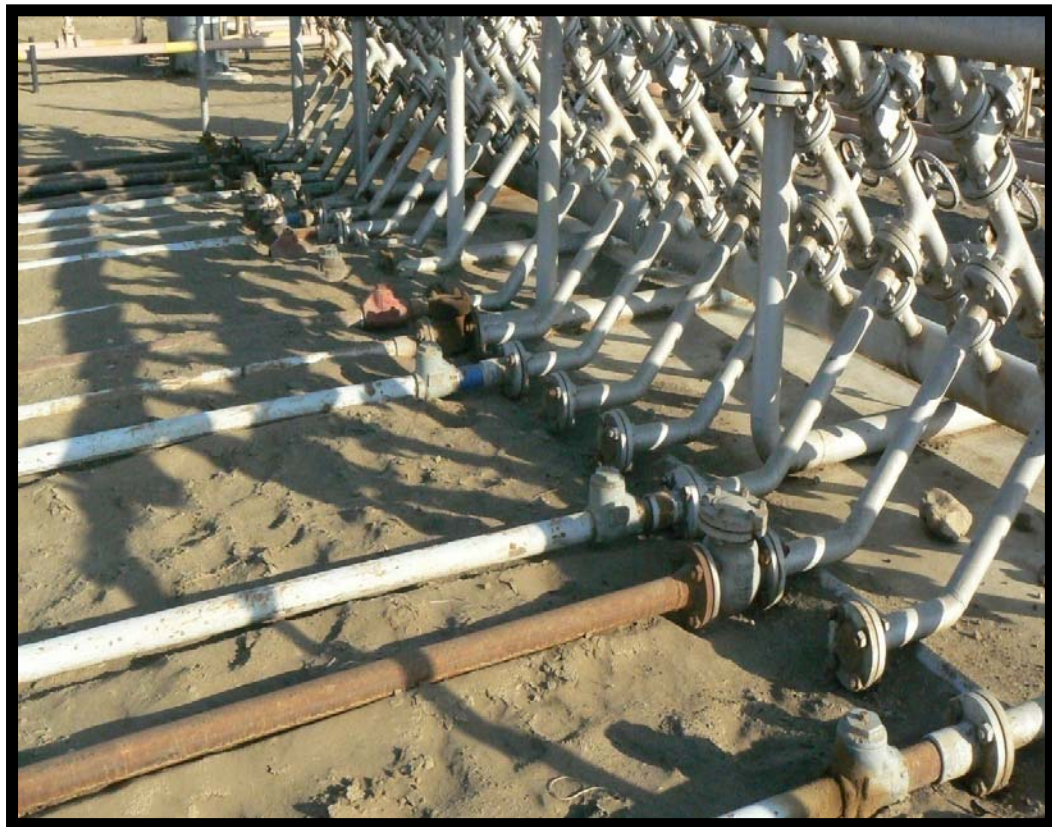
Figura 2.3 Líneas de flujo al múltiple de batería. [6]
