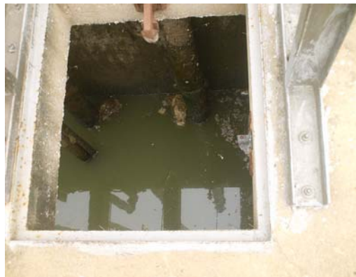
Figura 4.1 Tanquilla de bombeo
