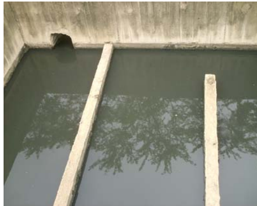
Figura 4.7 Camara de Cloracion
