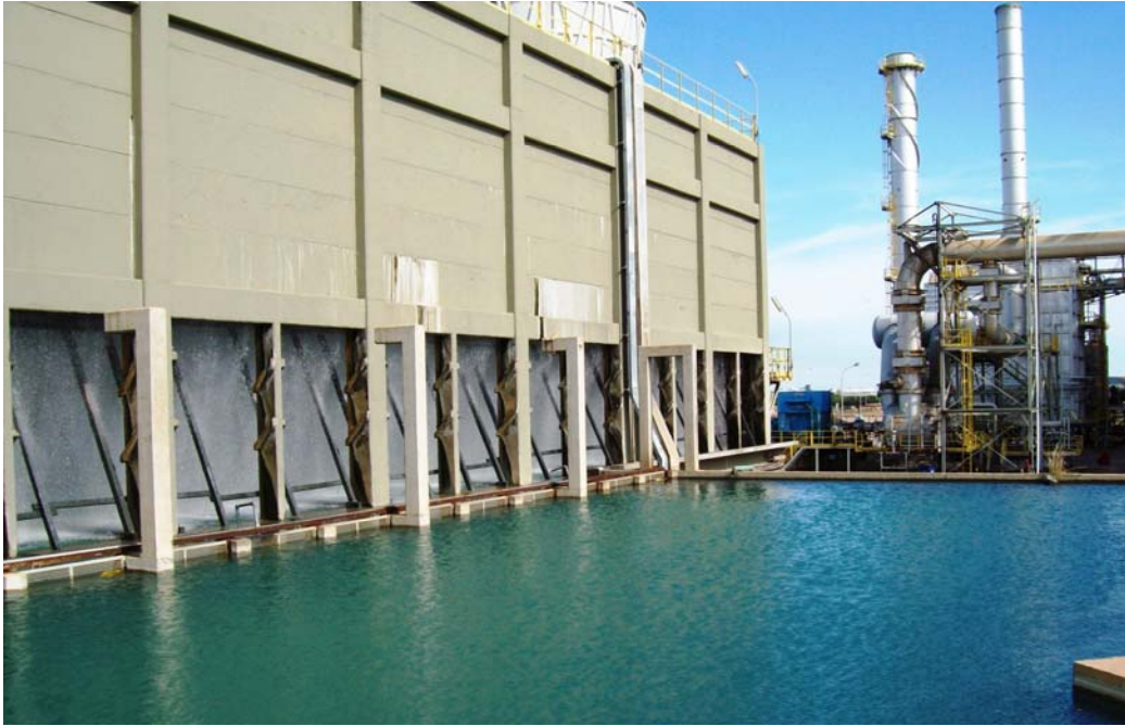
Figura 2.7. Unidad de servicios, torre de enfriamiento (Fuente propia)
