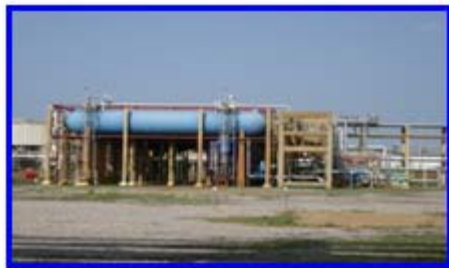
Figura N° 3.2. Balas de Almacenamiento de una planta fraccionadora de propano.
