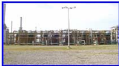
Figura N° 3.3. Balas de Almacenamiento
