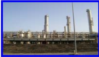
Figura N° 2.8. Enfriadores por aire.
