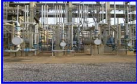
Figura N° 3.4. Tren de Pre-Calentamiento de la Planta despropanizadora
