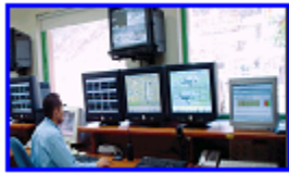
Figura N° 3.10. Panel de Control en una planta de fraccionamiento.
