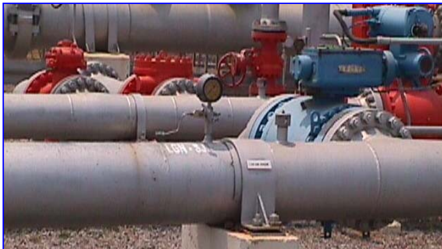
Figura 2.11 Fotografía del sistema de poliducto
