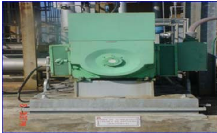
Figura 2.17 Bomba de alimentación.
