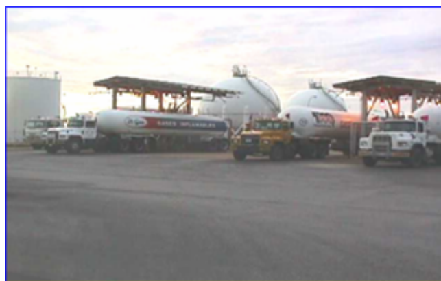
Figura 2.4 Estación de distribución y despacho de gas natural
