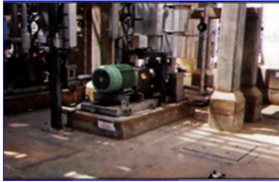
Figura 2.28 Bombas de Reflujo.
