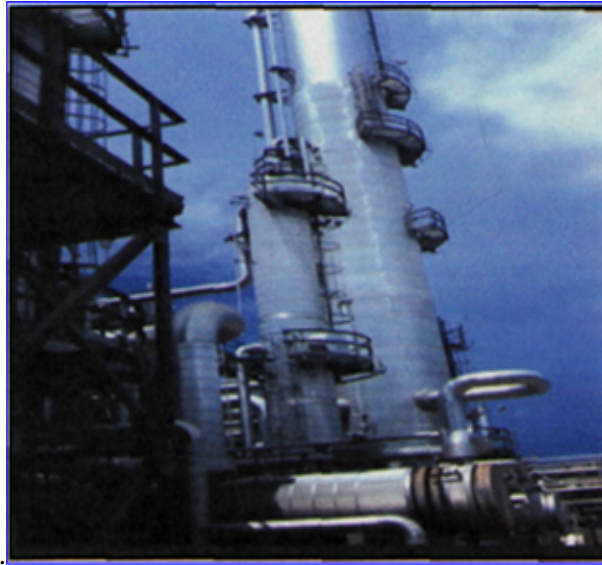
Figura 2.24 Torre Fraccionadora de Gasolina.
