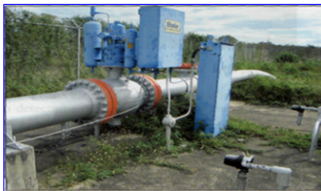
Figura 4.2 Estación automática con actuador neumático y accesorios de control.
