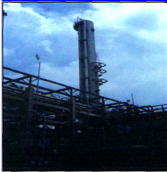
Figura 2.23 Torre Separadora de Butanos
