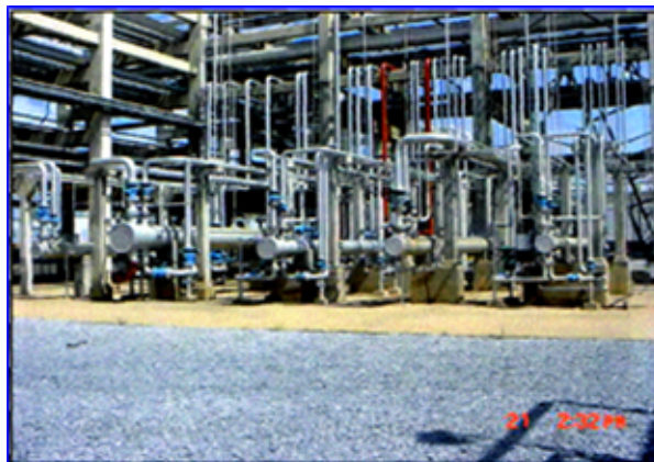
Figura 2.18 Intercambiadores de calor.
