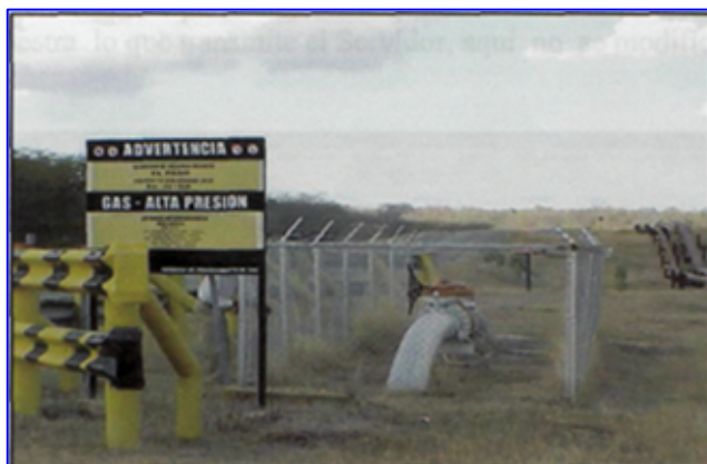
Figura 4.3 Estación de válvula manual.
