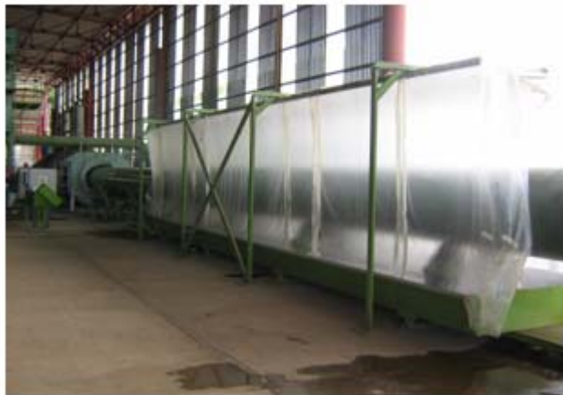
Figura 2.17 Batea de enfriamiento.
