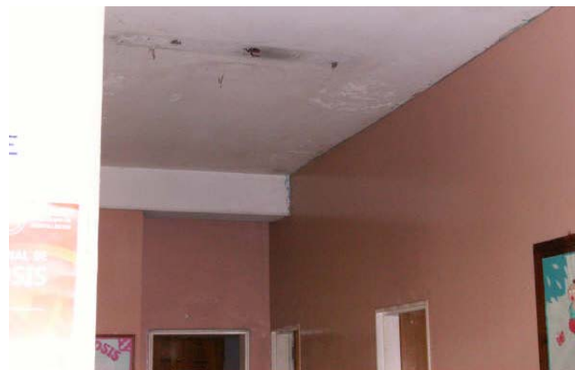
Foto 1. Instalaciones eléctricas inadecuadas
