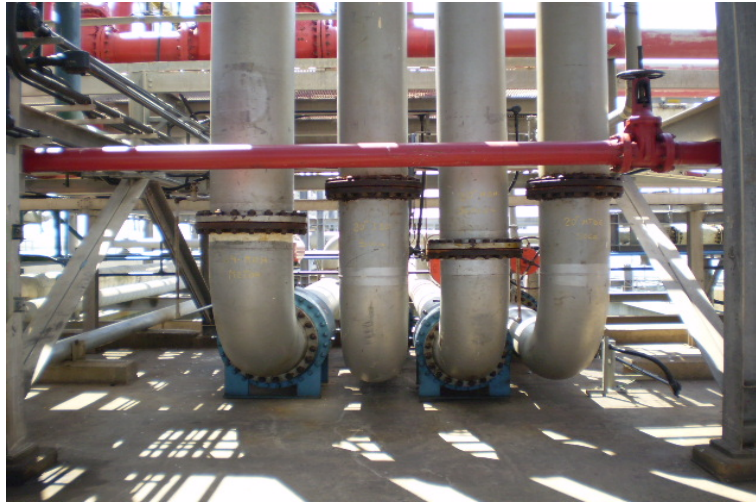
Figura 5. Tuberías de almacenamiento (líneas)
