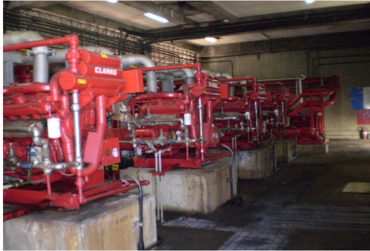
Figura 3. Sala de equipo de protección
