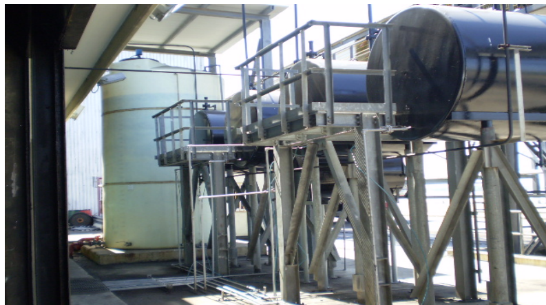
Figura 6. Tanque de almacenamiento de espuma y Tanques de combustibles
