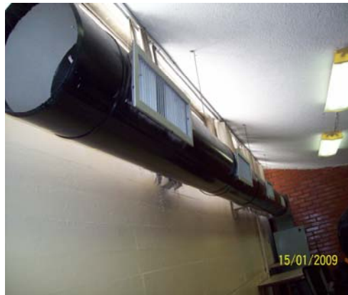
Figura 4.2. Ducto de aire acondicionado a la altura de cualquier estudiante. Fuente: elaboración propia.
