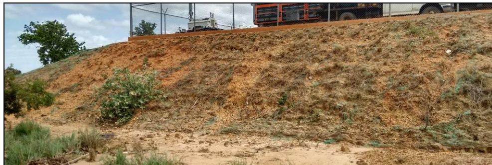
Figura 24. Talud de la zona Suroeste de MPJ-06
