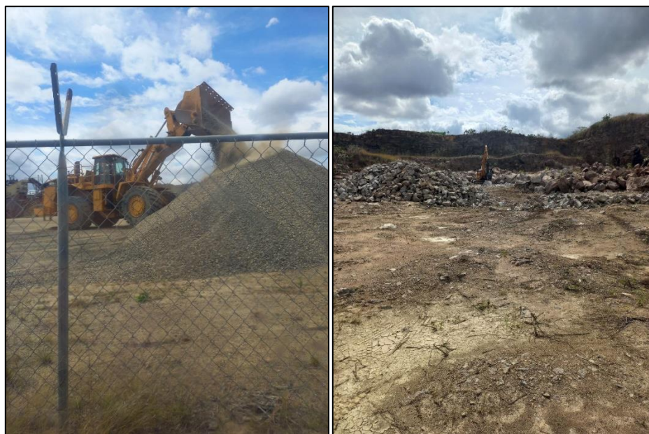
Figura 5.3 Aumento del ruido y del polvo que pueden afectar a los trabajadores por falta de E.P.P.
