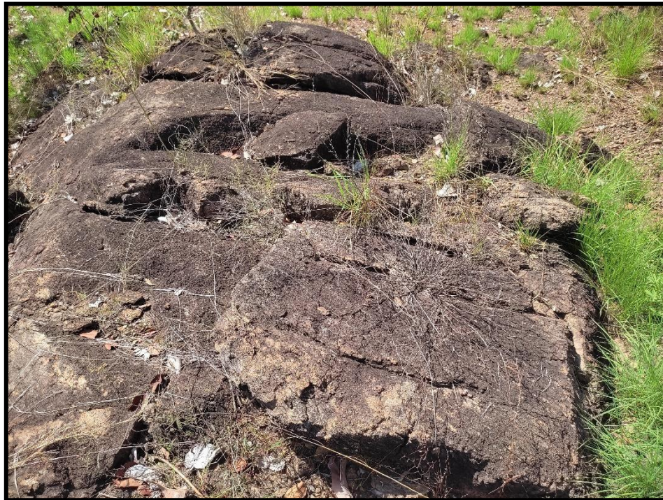
Figura 3.3 Diaclasas en los afloramientos de la quebrada Cardozo, sector del balneario Canaán.
