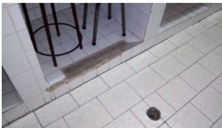
Figura. 4.1. Pisos deteriorados, sin cerámica
