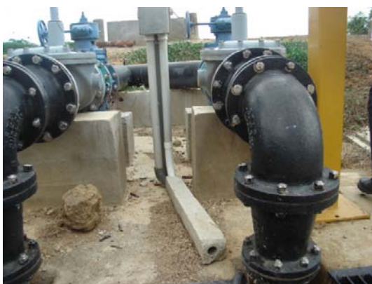
Figura.3.3. Estación de Rebombeo de Oxidación.
