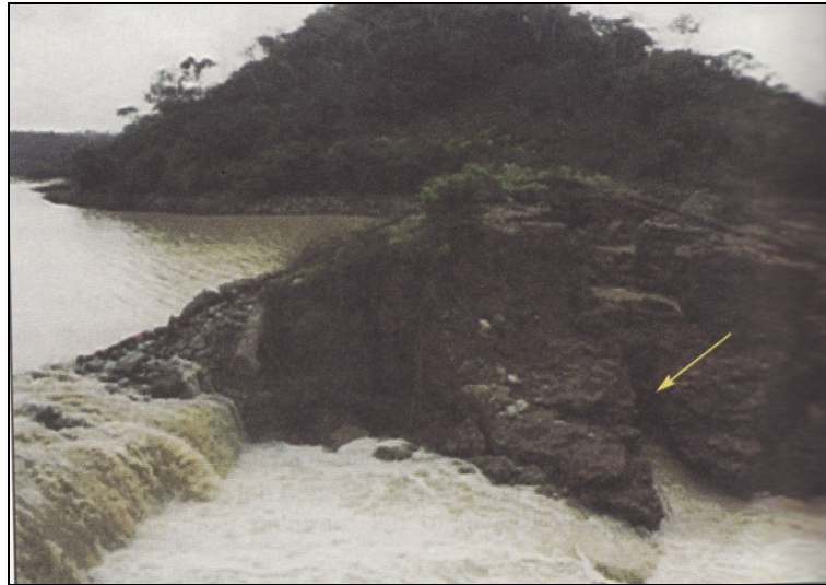
Figura N° 2.14. Presa el Cristo detalle de la erosión.
