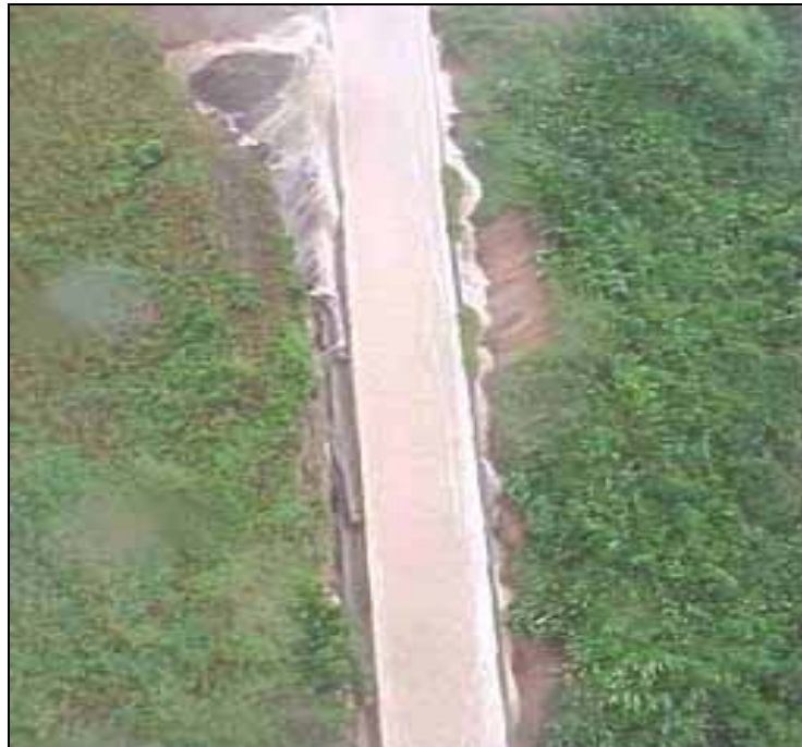
Figura N° 2.18. Incremento del rebose del canal, ya se observa la erosión del talud de la presa
