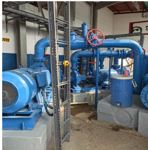
Figura 3.5. Estación de bombeo La Caraqueña
