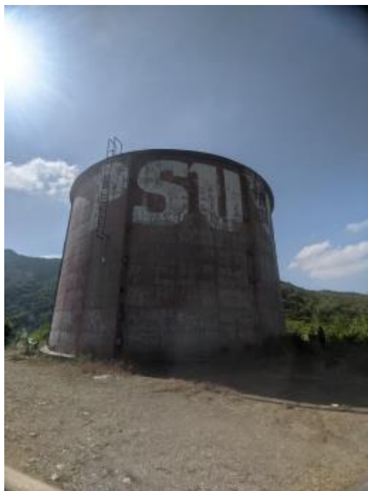
Figura 4.4. Tanque de Valle Verde
