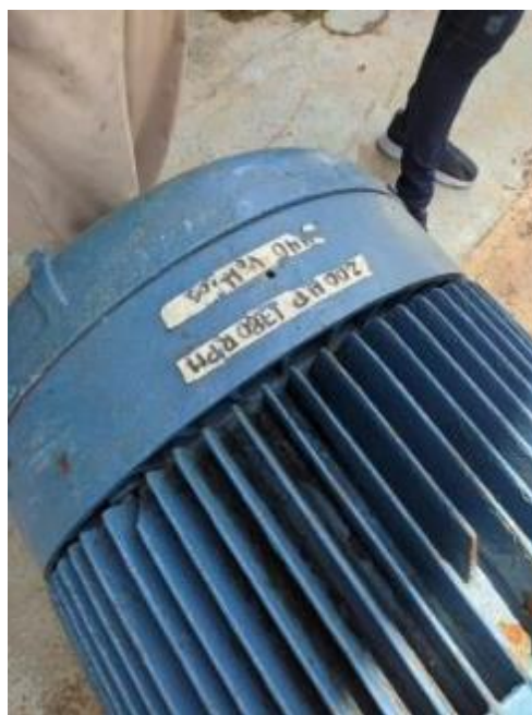
Figura 4.1. Bomba no operativa en la estación La Caraqueña
