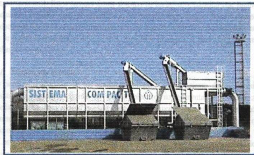
Figura 4.2, Sistema de desbaste de la planta de tratamiento de aguas residuales Ciudad de Guanta
