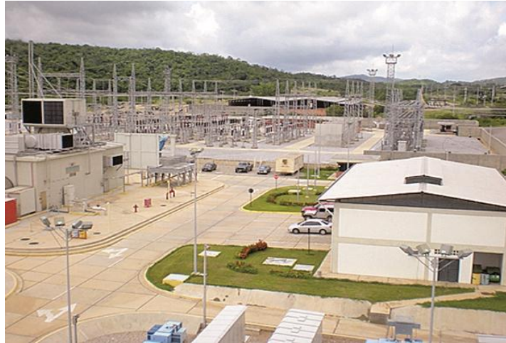
Figura 4.3 Central Termoeléctrica Argimiro Gabaldón – Estado Lara
