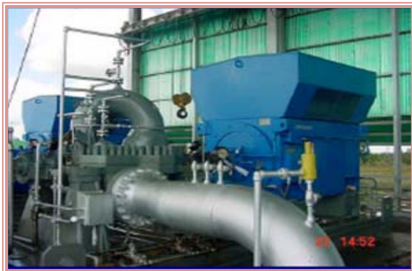
Figura 2.10. Bomba de Crudo Merrey [8]
