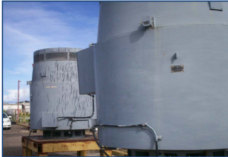
Figura 4.3. Bombas P-701 A y B del Sistema OSAMCO a la espera de su reparación y reinstalación.
