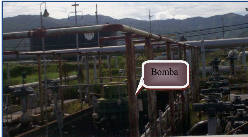
Figura 4.1. Estado Actual de las Bombas de Transferencia.
