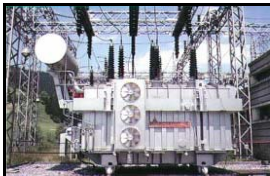
Figura 2.6.-Transformadores de Potencia
