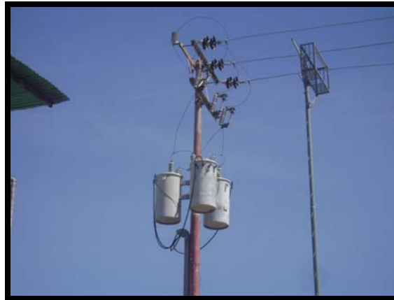
Figura 2.1.- Banco de Transformadores tipo Aéreo
