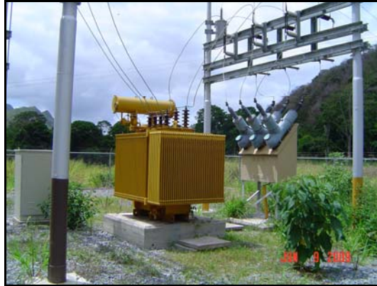
Figura 3.7. S/E San Antonio [El Autor]
