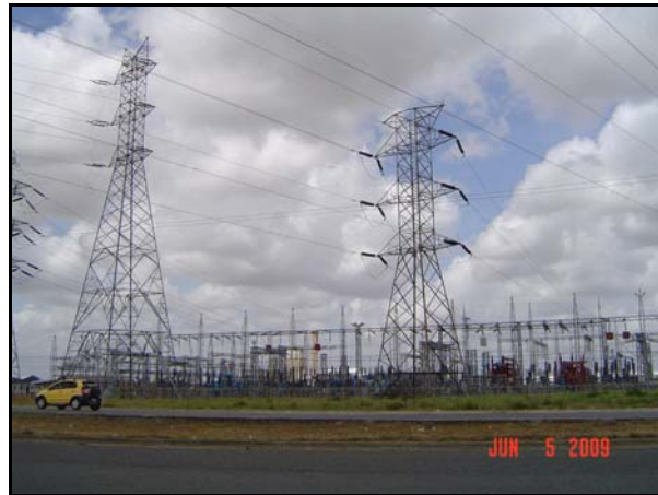
Figura 3.2. Salidas en 115 kV de la S/E El Indio [El Autor]
