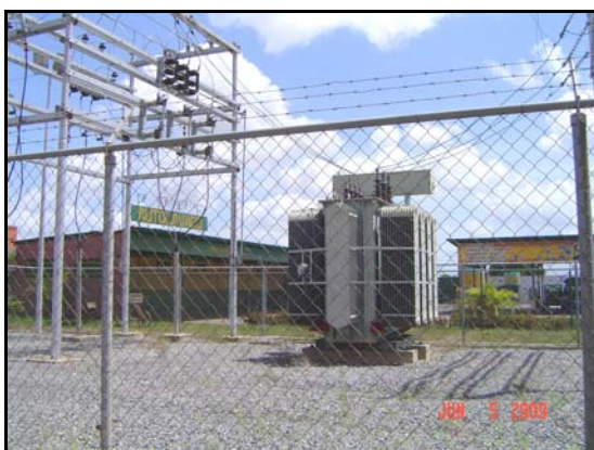
Figura 3.30. S/E La Cascada [El Autor]
