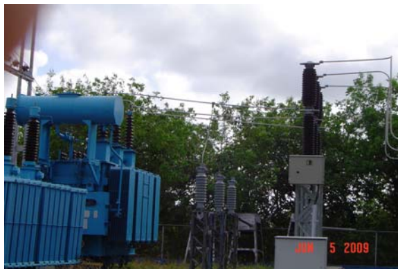
Figura 3.12. Transformador de la S/E Veladero [El Autor]
