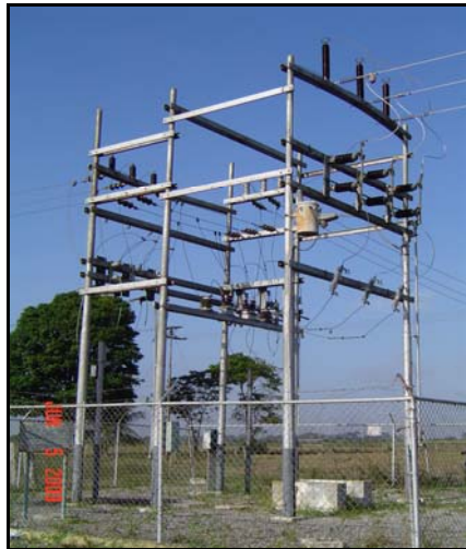
Figura 3.14. Transformador dañado de la S/E El Blanquero [El Autor]
