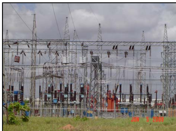
Figura 3.21. S/E El Indio Salidas en 34.5 KV [El Autor]
