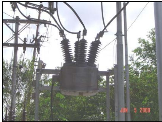
Figura 3.15. Reconectador Tipo GVR de la Salida del circuito Rural Sur [El Autor]
