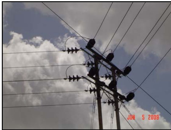
Figura 3.23 Salida del circuito rural Norte en la S/E Indio. [El Autor].
