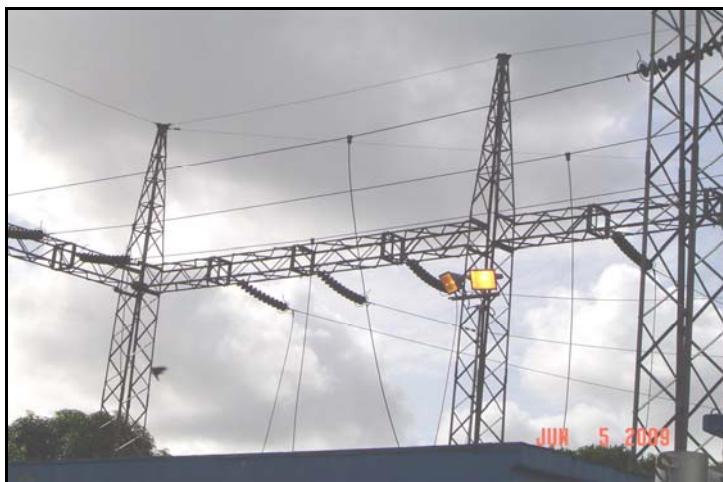
Figura 3.26. Pórtico 115 KV de la S/E Veladero. [El Autor]
