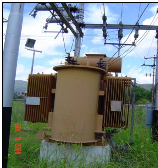
Figura. 3.9. S/E Paso Nuevo [El Autor]
