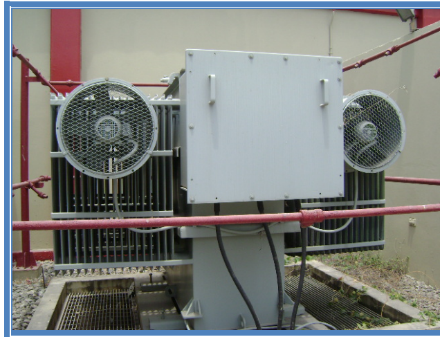
Figura 3.4 Transformador de Potencia de 2500 KVA
