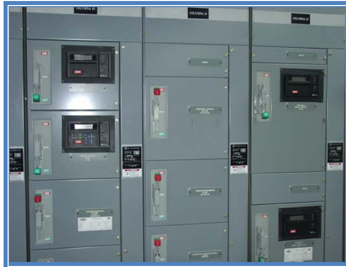
Figura 3.8. Interruptores de Potencia del Centro de Control de Motores
