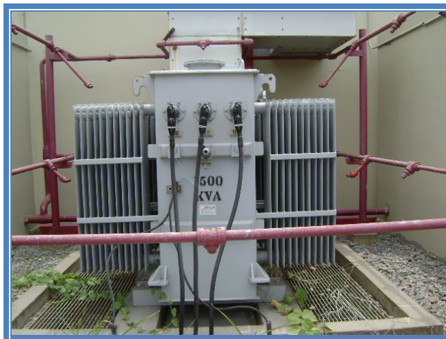
Figura 3.5 Transformador de Potencia de 1500 KVA
