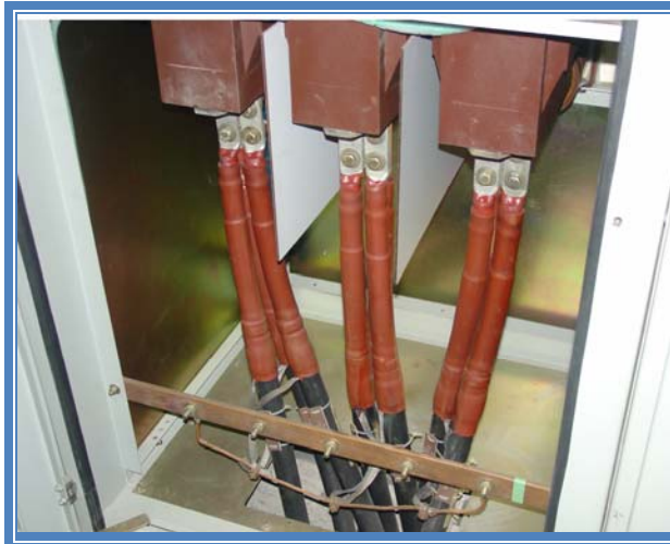
Figura 3.7. Conductores de Potencia conectados a una Barra de Distribución
