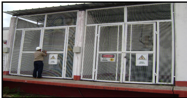
Figura 2.4 Transformadores de la subestación 07UB02 [El Autor].
