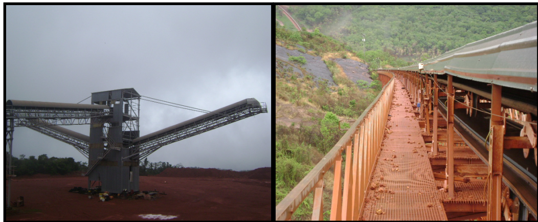
Figura 1.2 Tolva de transferencia (lado izquierdo). Correa de bajada (lado derecho), [El autor].
