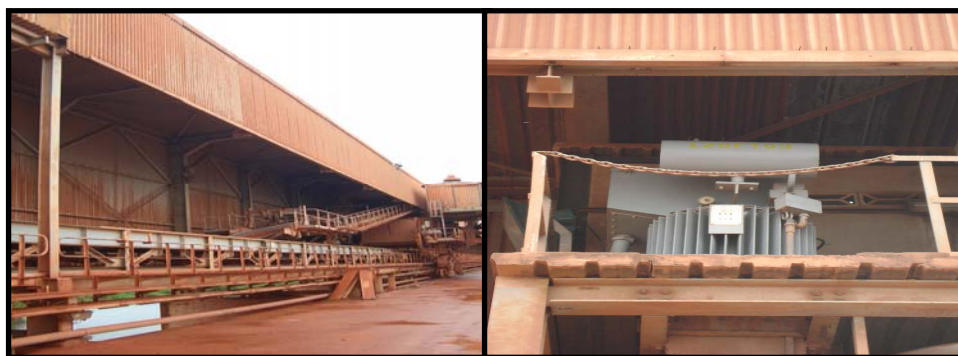
Figura 2.9 Subestación 08UB03 (derecha), Transformador 12BFT03 (izquierda) [El Autor].
