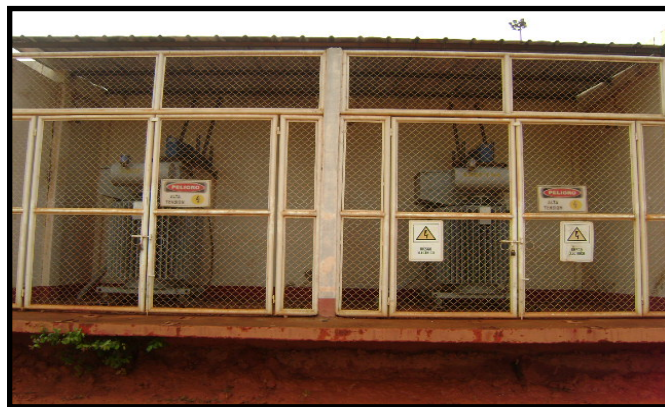
Figura 2.2 Transformadores de la subestación 07UB01 [El Autor].
