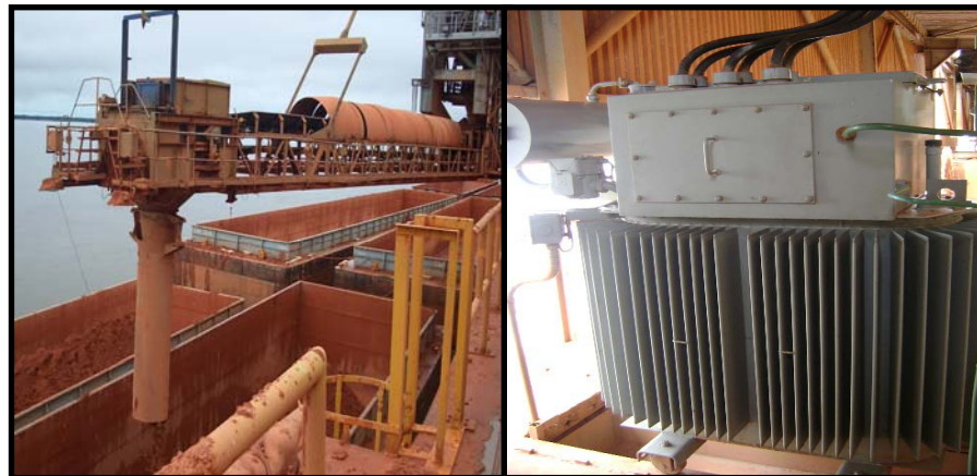
Figura 2.10 Cargadora de Gabarras (derecha), Vista Frontal del Transformador (izquierda) [El Autor].
