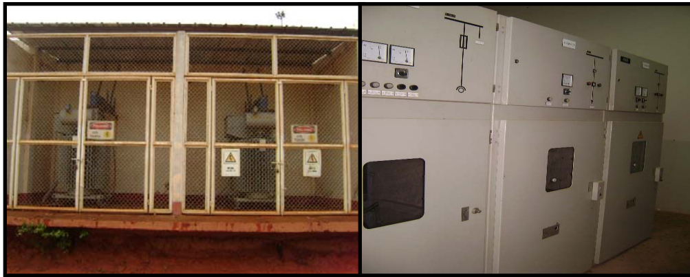
Figura 2.8 Subestación 08UB01 (derecha), Interior de la subestación (izquierda) [El Autor].
