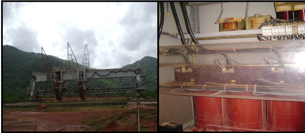
Figura 2.5 Recuperador RC 7.10 (Lado derecho), Transformador seco de 800 KVA (Lado Izquierdo) [El Autor].
