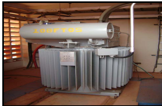
Figura 2.6 Transformador de la subestación 07UB03 [El Autor].
