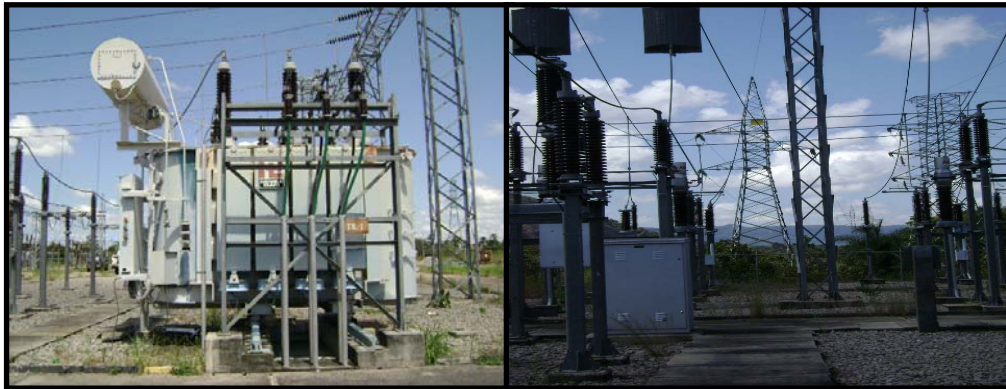
Figura 2.1 Transformador de la subestación Pijiguaos (lado izquierdo). Pórtico de salida a nivel de 115 kV (lado derecho), [El Autor].
