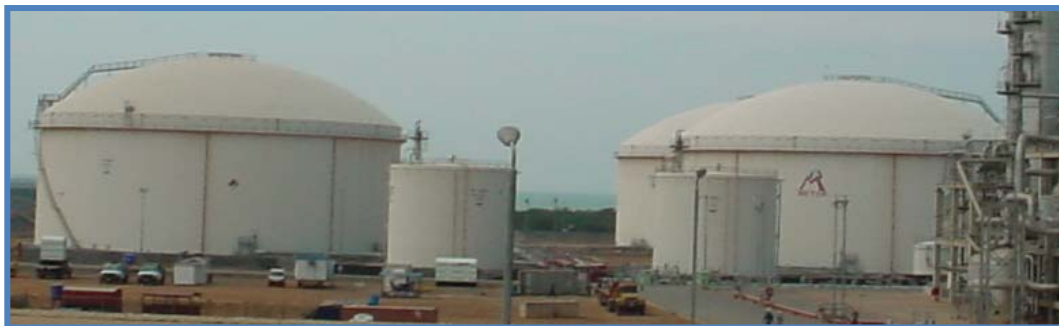
Figura 3.2. Tanques de Almacenamiento TK-801A/B/C, Planta METOR. [9]
